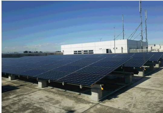
太陽光発電（本社屋上）
